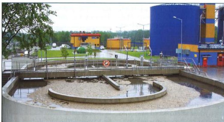
Fot. 3. Komora defosfatacji
